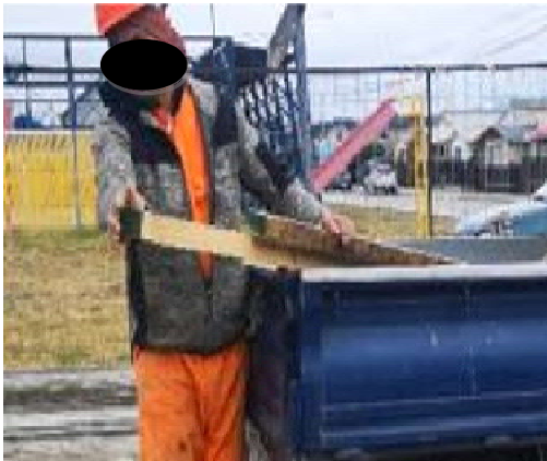
Se observa la carga de tablones desde el camión, para lo cual debe jalarlos con fuerza, ambas manos en agarre y codos extendidos. Sin uso de guantes.
