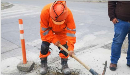
Se observa uso de picota. La toma con ambas manos, agarre con fuerza, abriendo un surco en donde colocará el moldaje. Realiza movimientos amplios de flexoextensión de codos. Sin uso de guantes.
