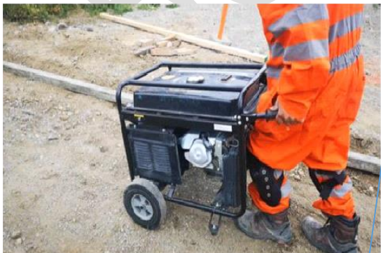
** No estaba la máquina apisonadora en el momento de la visita, por lo cual se simuló el agarre con un generador. Se observa uso de placa apisonadora para compactar el material, debiendo empujarla por todo el terreno. Agarre con ambas manos, fuerza de empuje, codos en postura mantenida de 60° aproximadamente. Sin uso de guantes.
