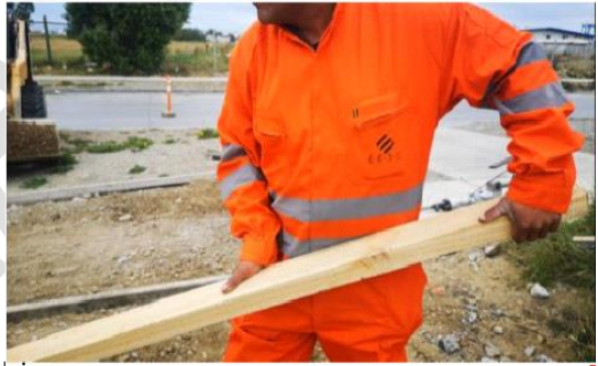
Se observa uso de niveladora manual de madera, la cual pasa por la superficie del material para emparejarlo. La toma con ambas manos en agarre, con flexión de muñeca y movimientos de flexoextensión de codos, en rango y frecuencia variable. Sin uso de guantes.
