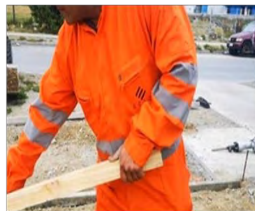
Se observa tablón retirado desde el camión, movimientos de flexión y extensión de codo derecho, agarre con fuerza de ambas manos. Sin uso de guantes.
